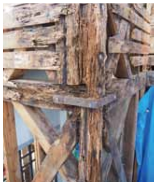
▲塔屋隅柱の腐朽
