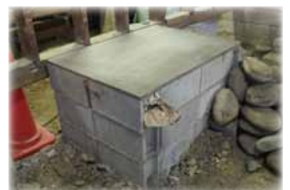
▲床板を剥がして土台が露出
